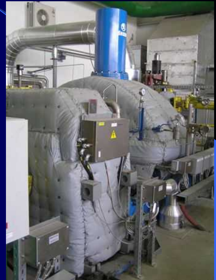
Teplárna Plzeňské teplárenské, a.s. – kotel na biomasu 15 MW t / 10 MW e
